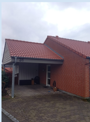
Facade på gavl - Mosbegroninger på mørtelfuger
