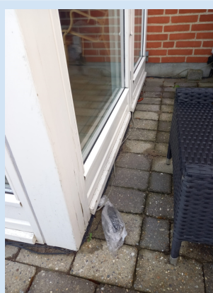
Hjørnestolpe ved udestue og drypnæser i træ
