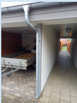
Træbeklædning, som er godt beskyttet af udhæng og derfor har brug for mindre vedligehold
