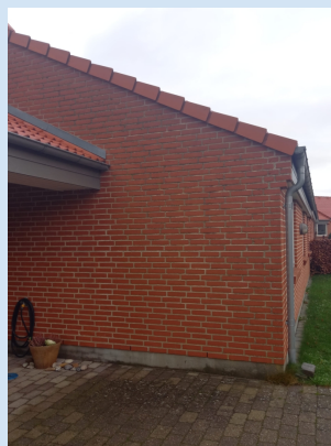
Facade på gavl - Mosbegroninger på mørtelfuger
