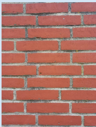
Facade på gavl - Mosbegroninger på mørtelfuger
