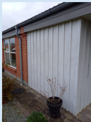
Beklædning som er udsat og trænger til maling
