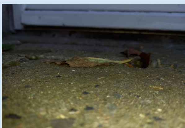
Eksempel på gummifuge som trænger til at blive udskiftet
