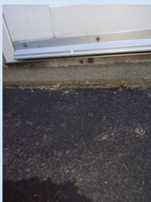
Eksempel på gummifuge, som trænger til at blive udskiftet
