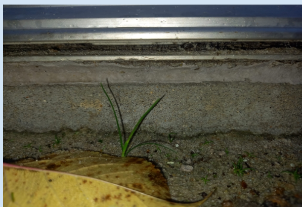
Eksempel på gummifuge, som trænger til at blive udskiftet
