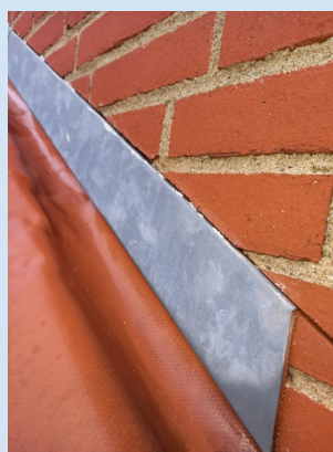
Betontag - Indskudt zink i murværk ved garage, fuger er smuldret væk
